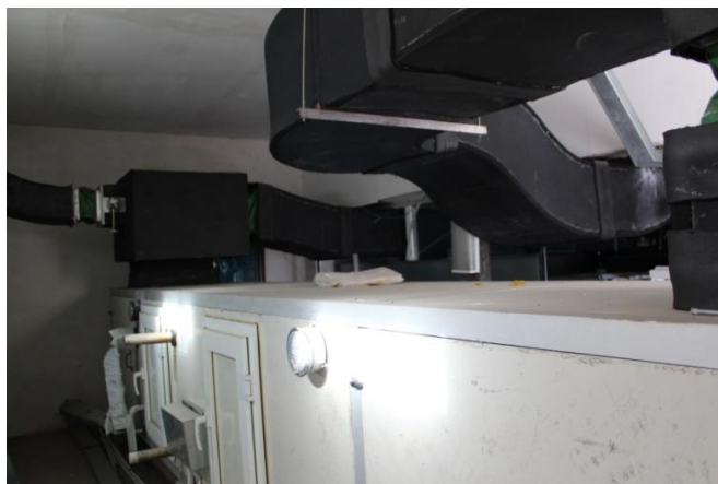
Рисунок 3 – Вентиляционная камера в пространстве «двойного потолка»
